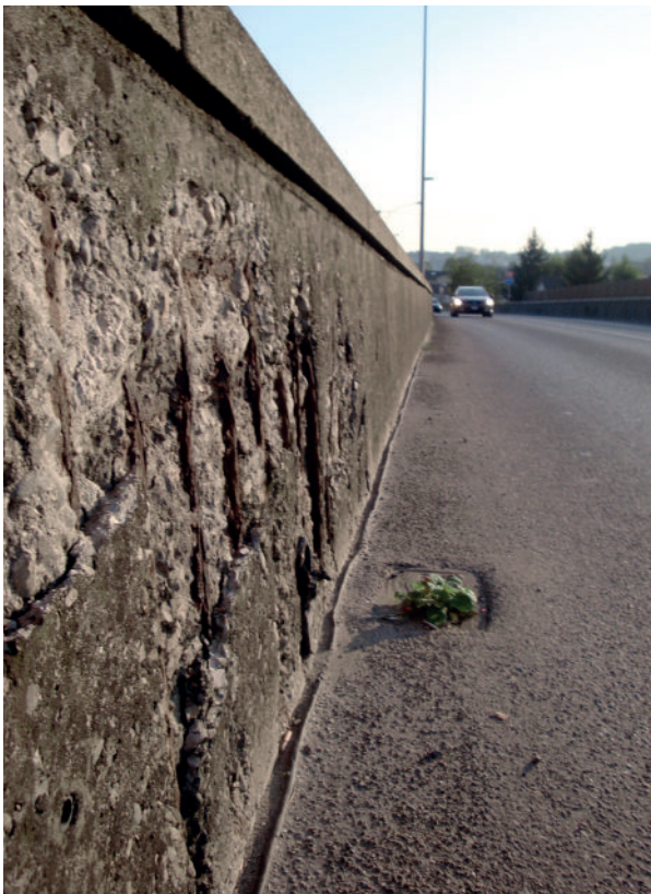
Korrosion infolge Chlorideinwirkung
