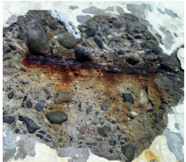
Betonabplatzung infolge Bewehrungskorrosion
