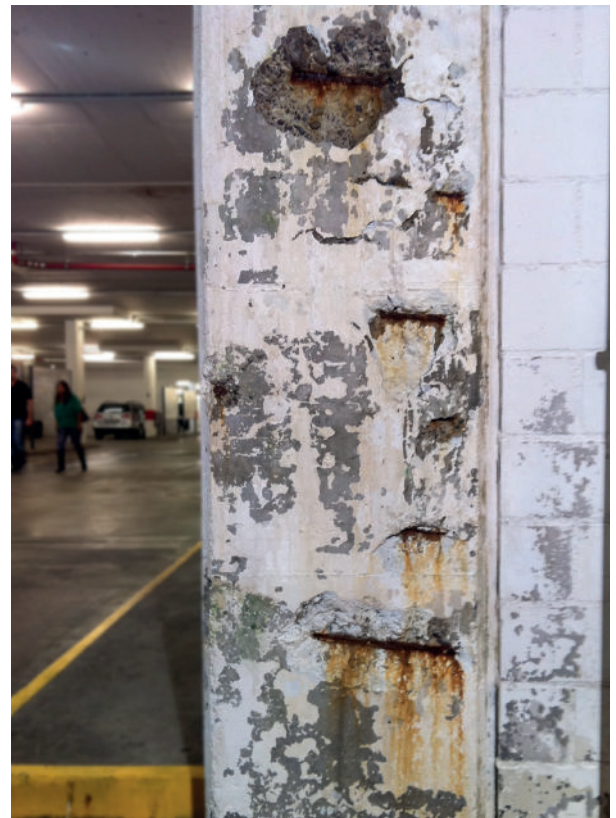
Korrosion infolge Karbonatisierung des Betons
