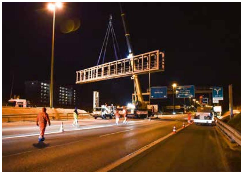
Einheben eines Signalportalträgers in der Nacht. Während 15 Minuten musste die Autobahn A1 hierfür voll gesperrt werden.
