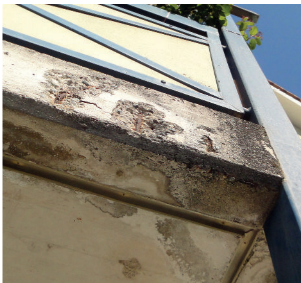
Enrobage insuffisant par endroits
