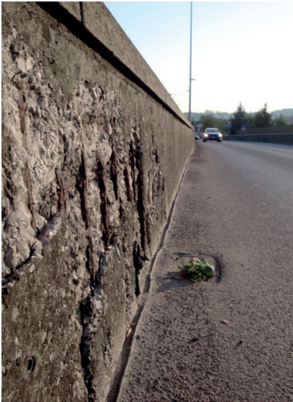
Korrosion infolge Chlorideinwirkung
