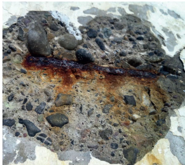
Betonabplatzung infolge Bewehrungskorrosion
