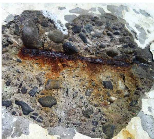
Eclatement du béton suite à la corrosion de l'armature
