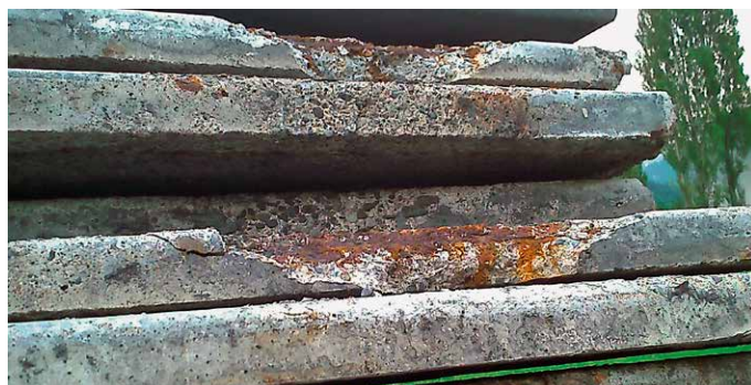
Corrosion de l'armature et éclatement du béton sur les anciens panneaux
